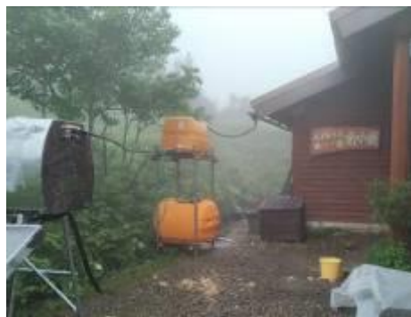
雨樋に流れてきた雨水を雨水タンクに貯め、太陽熱温水器のタンクに流れこむようになっています。
